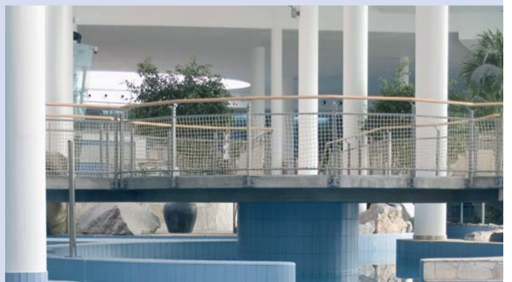
Auf Konstruktionsteile aus Stahl und Zink hat das feuchte Raumklima eine belastende Wirkung.
