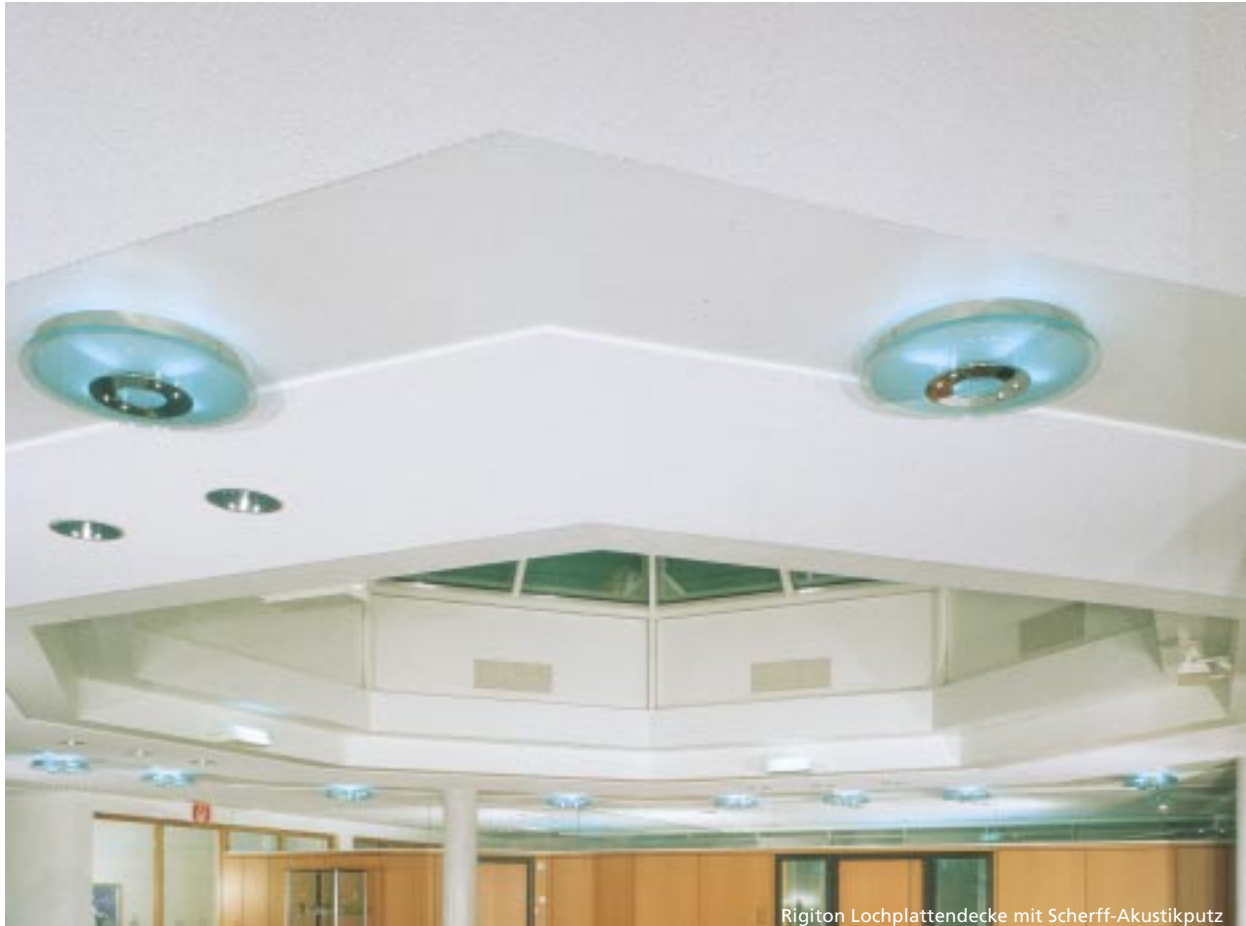
Rigiton Lochplattendecke mit Scherff-Akustikputz
