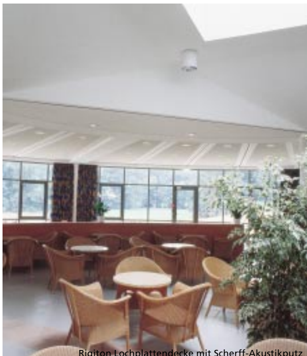
Rigiton Lochplattendecke mit Scherff-Akustikputz
